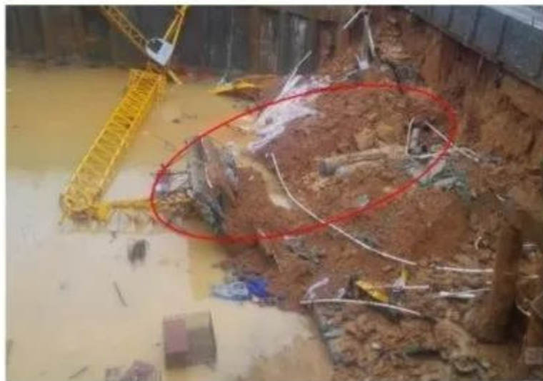
塔吊基础设置不合理
